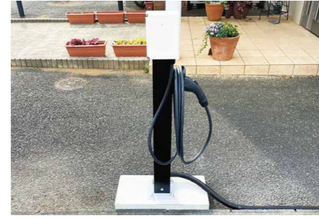
EV充電器の設置に当たり同社は現地調査、見積作成、補助金申請(書類作成)、工事、保守メンテナンスまでワンストップサービスを展開する。
